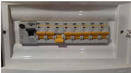
Рис.62. Электрощиток с предохранителями.
